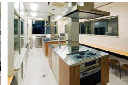
試作室 / 調理台、収納棚、作業テーブル ほか 給食管理実習室に隣接した教員用の調理室。研究室ともつながる。
