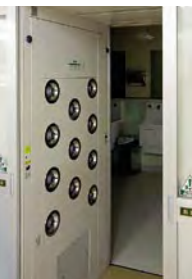
エアシャワー 厨房のプレールーム。入室前の除塵を行う。
